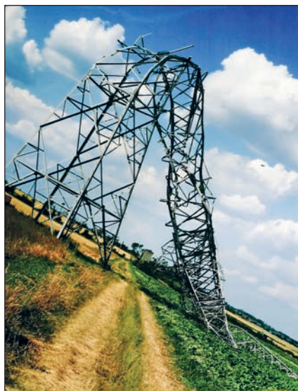
Dabei kann der Wind auch Leitungen schaden, hier ging ein Tornado durch. Foto: Stefan Vockrodt
