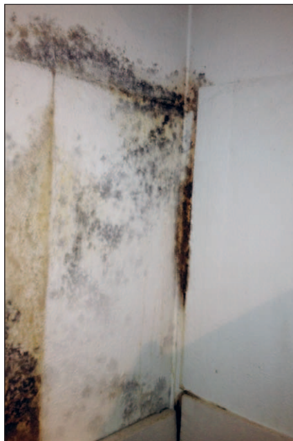
Bei solchen Flecken in der Wohnung hilft nur noch: Tapete runter, Putz runter und trocknen lassen.
