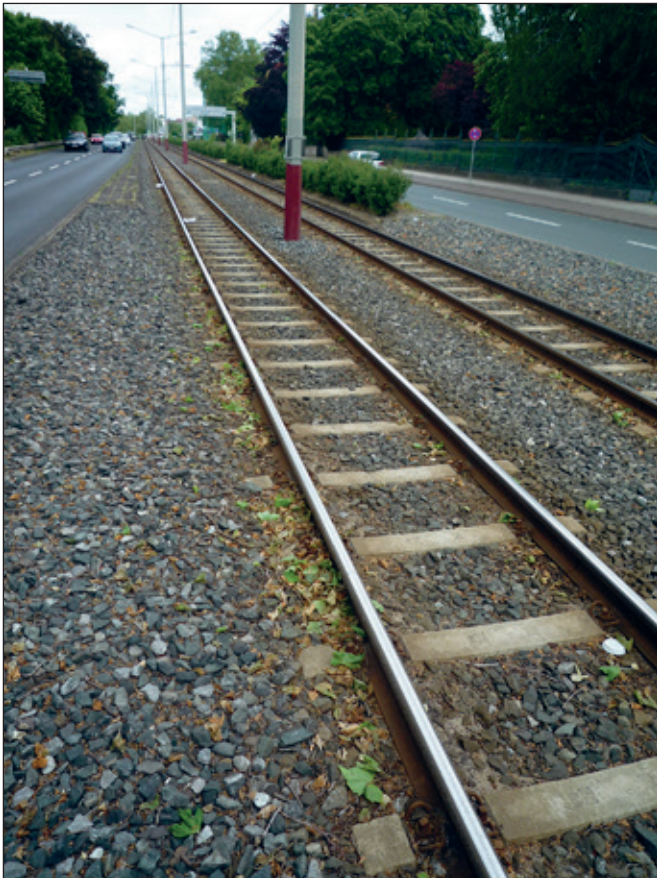
Nicht unbedingt schön, aber seit über hundertfünfzig Jahren bewährt: Oberbau mit Vignolschienen, Querschwellen und eingeschottert wie hier auf der Wolfenbütteler Straße.
