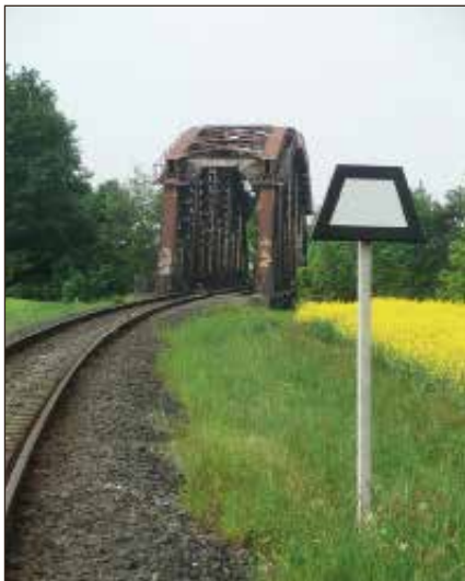
Die Kanalbrücke könnte einen neuen Anstrich vertragen – doch sie trägt auch noch die schweren Güterzüge. Foto: Robert Slawski
