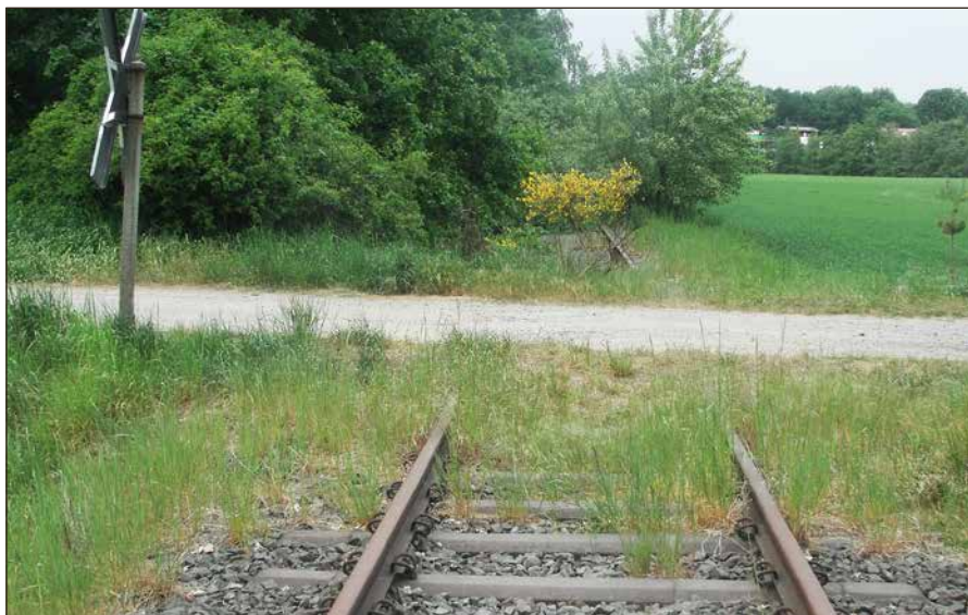
Das Gleis nach Wendeburg muss einmal durchgearbeitet werden, dann können dort wieder Züge rollen.
