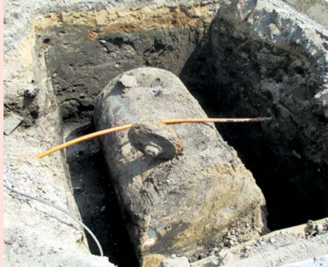
Eine Bodenverunreinigung kann durch einen verrotteten Tank verursacht werden.
