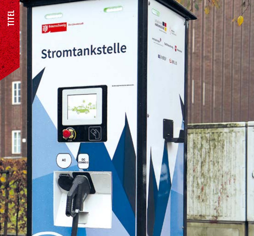
Ladesäule für Elektro-Pkw mit verschiedenen Systemen.
