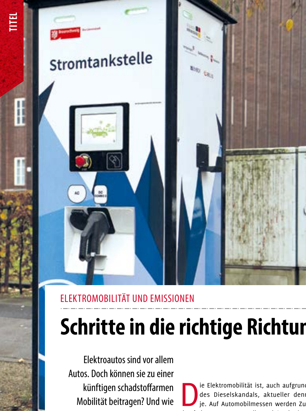
Ladesäule für Elektro-Pkw mit verschiedenen Systemen.
