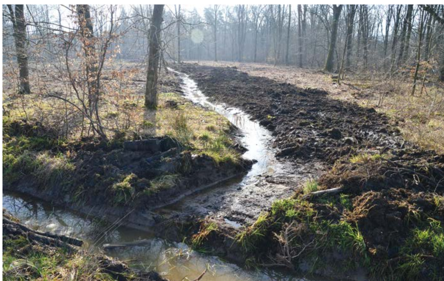
Entwässerung alter Waldstandorte, hier im FFH-Gebiet 102, Niedersächsische Landesforsten.
